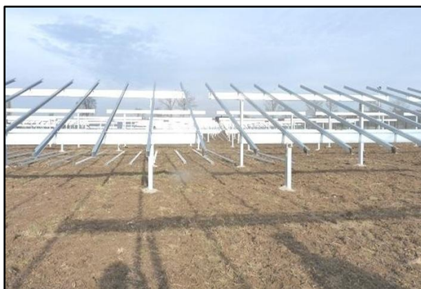
Rysunek 11 Przykładowa konstrukcja stalowa - stelaż pod panele fotowoltaiczne
