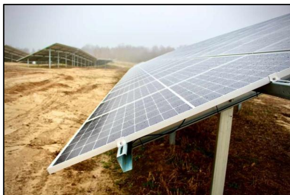
Rysunek 10 Panele fotowoltaiczne montowane na konstrukcji wsporczej (źródło: sozosfera.pl)
