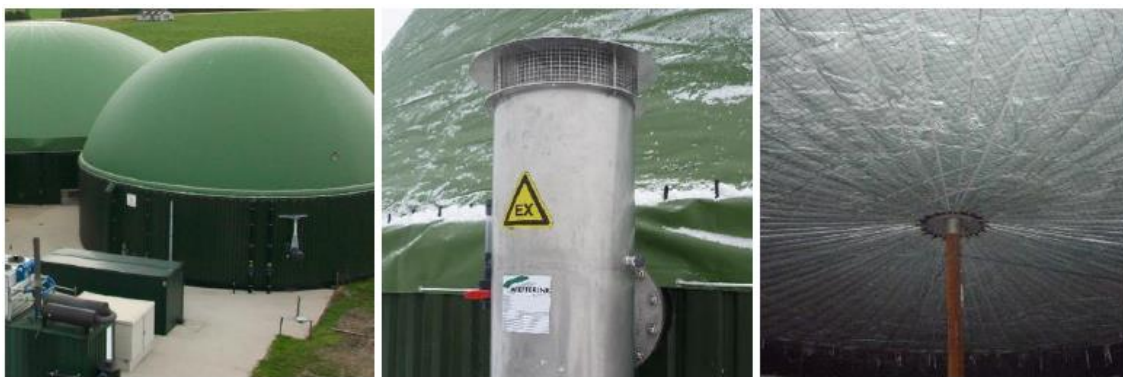
Rysunek 14 Zbiornik biogazu w postaci pokrycia dachowego tzw. membrany (rysunek z lewej). zawór bezpieczeństwa nadciśnienia gazu w zbiorniku (rysunek w środku); membrana z konstrukcją podtrzymującą wewnątrz zbiorniku (rysunek z prawej).
