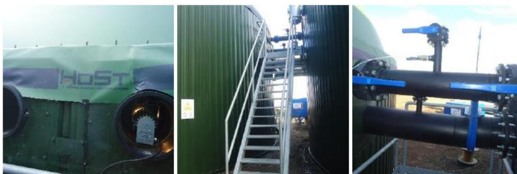
Rysunek 12 Wizjer wnętrza komory fermentacyjnej (rysunek z lewej); drabinka z platformą inspekcyjną (rysunek w środku); rurociągi przepływowe między zbiornikami (rysunek z prawej).
